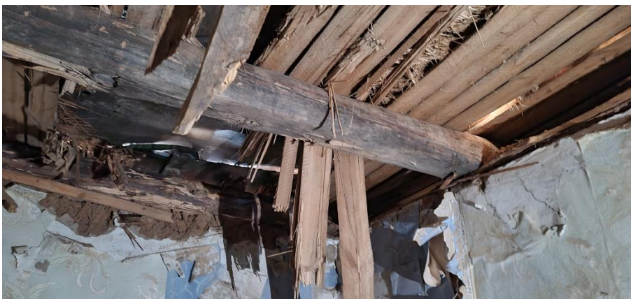
Een plafond verwoest door raket inslagen. De woning is onbewoonbaar. Geld en middelen om te repareren zijn er niet.
