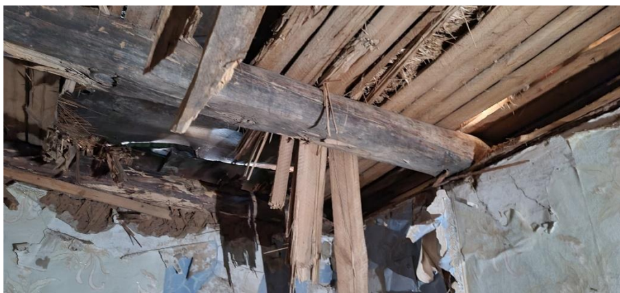
Від ракетних ударів було зруйновано стелю. Будинок непридатний для проживання. Грошей і ресурсів на його ремонт немає.
