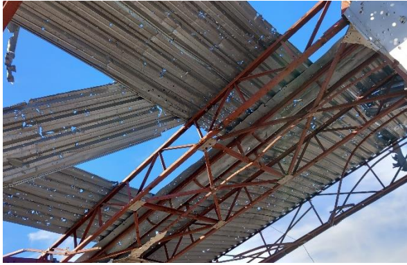
Kogelgaten in dakplaten tankstation
